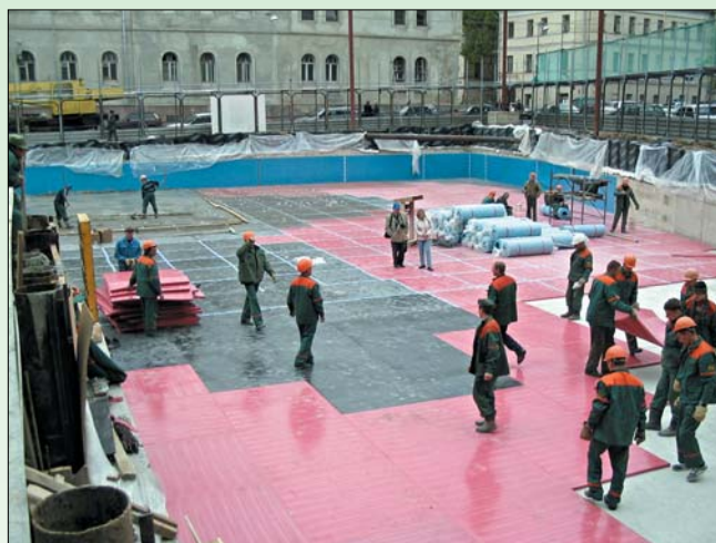
Виброизоляция жилого здания на 1-м Колобовском пер. выполнена на горизонтальных (черный и красный Sylomer®) и вертикальных (синий Sylomer®) поверхностях. На вертикальные поверхности материал приклеен к бетону двухкомпонентным клеем
