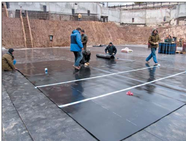
При строительстве здания на ул. Русаковской маты Sylomer® (черного цвета) укладывались на горизонтальное бетонное основание в два слоя. Стыки матов соединены скотчем
